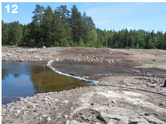
Figur 12. Dam nr. 3 er ferdig og fylt med vann. Vanningsområde 3 er det mørkere, fuktige arealet lengst bak på bildet. Foto: RG 11.06.2020.
